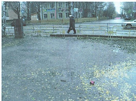
Фото № 3, 4 Перепад высот у тротуара при входе на территорию
